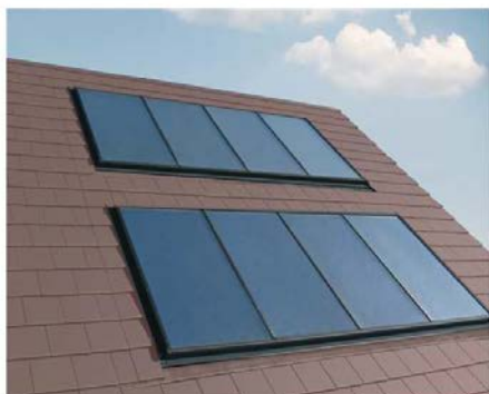
PV-Module anthrazit aufgesetzt
