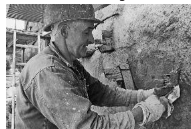
Paul Helfrich von der Firma Renovum schlägt vor der Verfüllung der Mauerlöcher in Wandöffnungen um Rückzugsräume und Nistgelegenheiten für Fledermäuse und Mauersegler zu schaffen. (Foto: Thumm)
