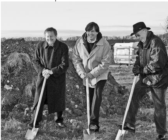
Paul Sailer, Jürgen Kollmar und Karl-Ernst Schmitt setzen den ersten Spatenstich zum Mehrgenerationenwohnen. (Foto: Faul)
