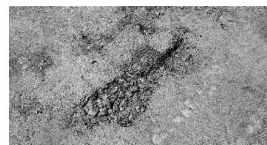
Frostschäden setzen den Straßen zu.
