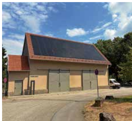
Mit Mitteln der Städtebauförderung wurde nun die ZEAG-Scheune saniert und mit einer PV-Anlage für den Eigenbedarf des Pumpwerks sowie des Rathauses ausgestattet
